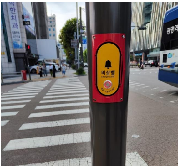
Figur 5: Emergencybell placeret på lygtepæl.
